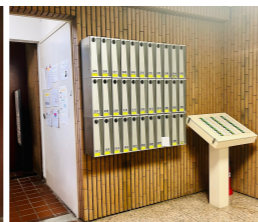
▲館内ポスト&在宅確認盤(各室用)
